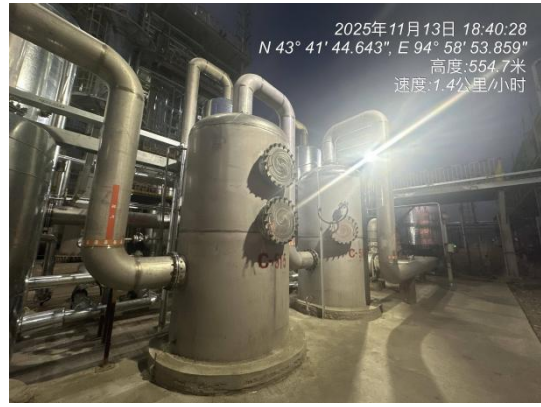
废气治理设施
