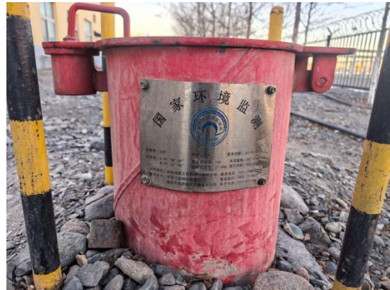
地下水监测井
