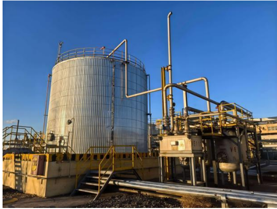
1000 方二甲基二硫储罐及活性炭吸附设施
