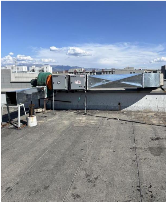
废气处理设施
