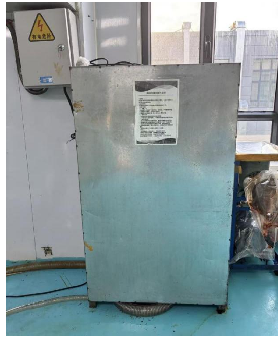
隔油、沉淀装置
