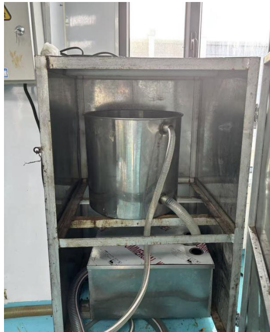
隔油、沉淀装置
