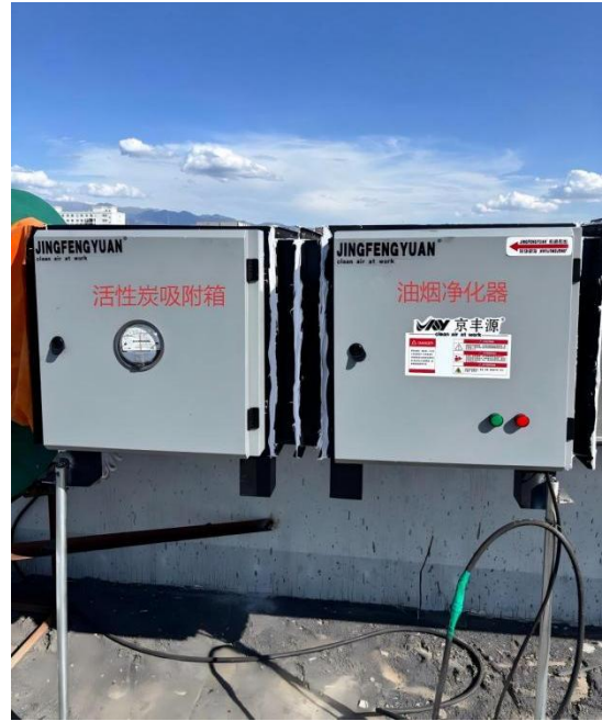
废气处理设施
