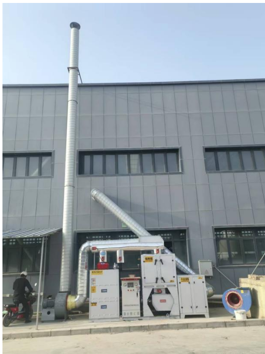
活性炭+蓄热式催化炉及排气筒
