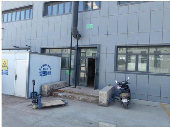
锅炉房与锅炉废气排气筒
