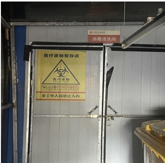
医疗废物暂存间
