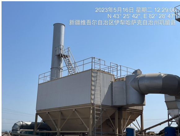
塔顶排气筒及除尘设施
