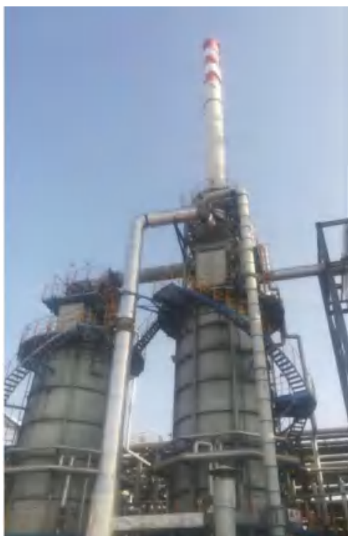
脱酚塔进料及减压进料加热炉排气筒
