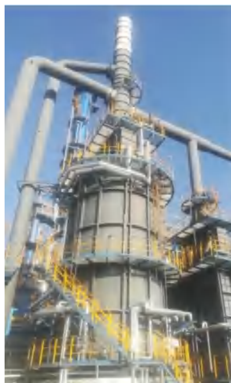
进料、炼化进料及分馏塔进料加热炉排气筒
