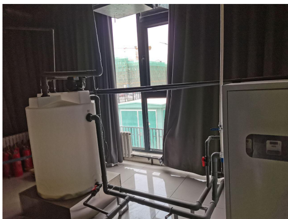
实验室污水处理设施
