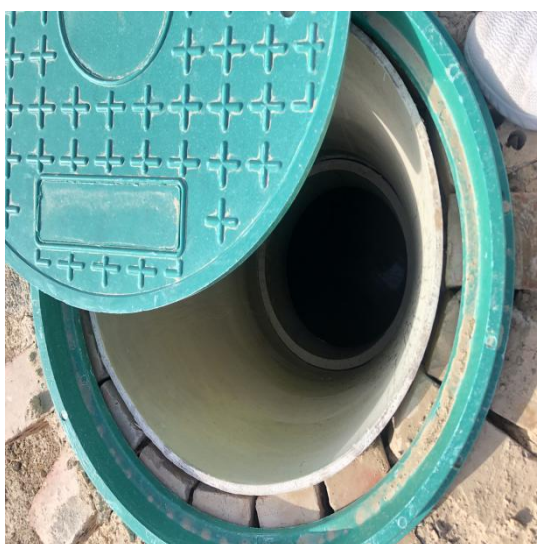
地埋式污水处理设施
