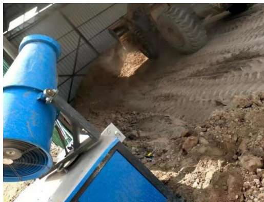
原料上料雾炮喷淋
