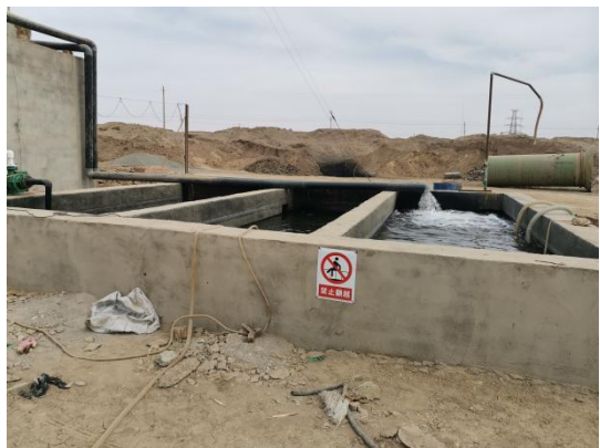
脱硫塔循环池
