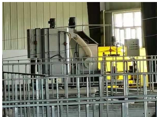
污水处理控制系统
