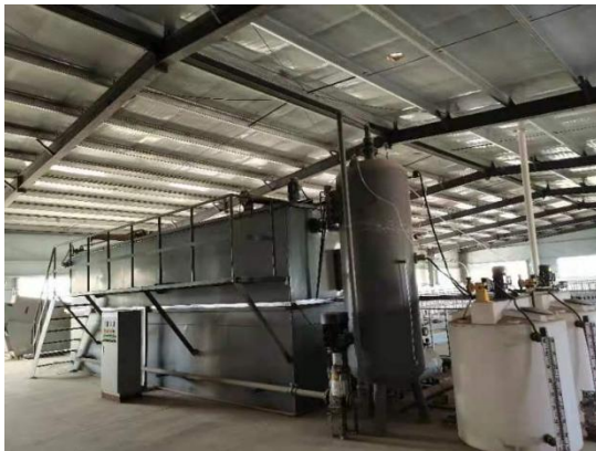
污水处理系统
