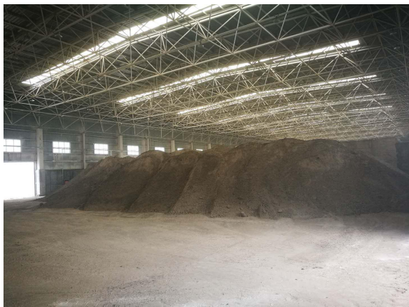
混合材堆棚内部
